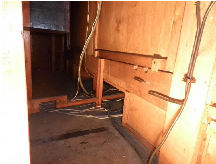
14. Abbildung: Am Innenseite des Gehäuses verlegte Verkabelung der Steckdosen
