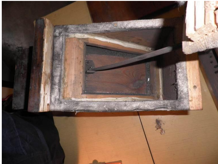
21. Abbildung: Das alte Drosselventil
